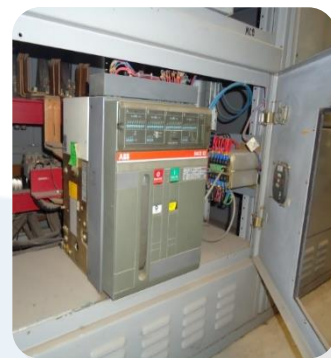
Interruptor en Baja Tensión de los años 80's
